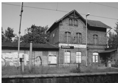
写真4 ベルリンの郊外ドイツ鉄道ダーレビッツの駅舎。タウトもここから電車で勤務先のあるベルリンへ通ったであろう。現在は無人駅となりプラットフォームも雑草が生い茂っている。
