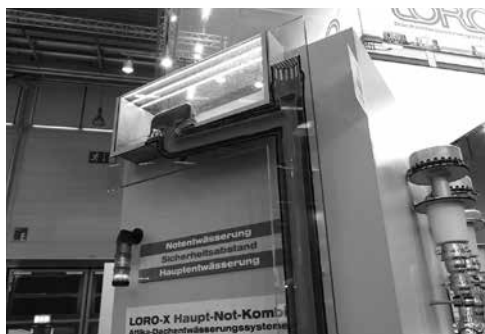
写真24 集中豪雨対策に雨水排水縦管に通気を取った例(LORO社)
