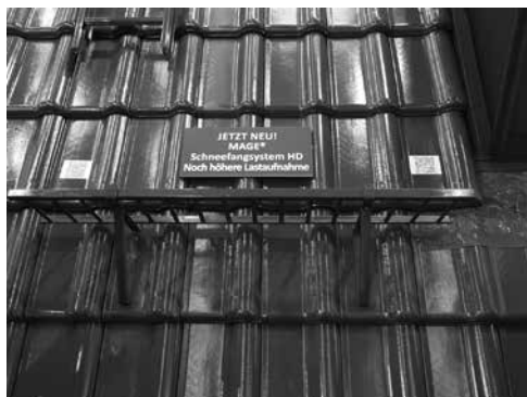
写真23 雪の落下防止装置のある屋根瓦(より大きな積雪荷重に耐えられる)
