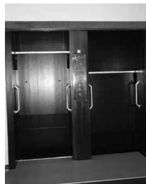
写真 22 放送局の停止しないエレベーター
