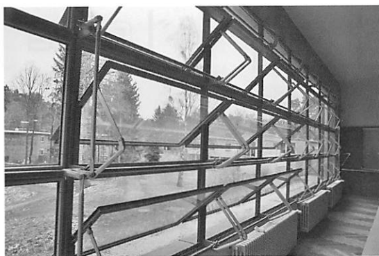
写真-10 全ドイツ労働組合総同盟の研修学校の自然換気装置
