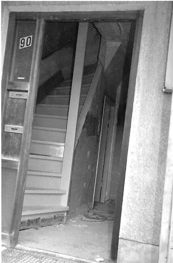
写真8 損傷の進んだ住棟の内部
