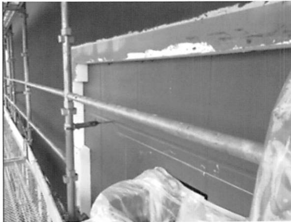
写真6 (養護老人ホーム明水荘) 所在地:愛媛県西条市小松町、鉄 骨造2階建て、外装下地:ALC、断熱面積:2240㎡、断熱 材厚さ:70mm、一部100mm、設計事務所:新企画設計、施工: 戸田建設四国支店、断熱施工:EIFSJAPAN
