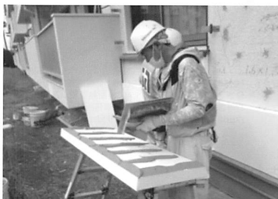
写真3 (花見川住宅) 所在地：千葉県花見川区花見川、竣工：1968年6月、構造：RC造5階建て、住戸数：40棟、1530戸、断熱材：EPS、断熱材厚さ：60mm、断熱施工面積：10,333.88㎡、設計：高屋設計環境デザインルーム、施工：鹿島建設総合管理、StoJapan
