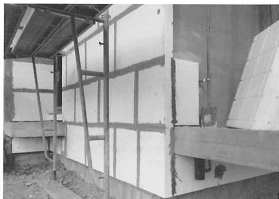
写真2 サンシャイン計画における外断熱工事、構造：壁式RC2階建て、延べ床面積：118㎡、竣工：1977年、設計・施工：大林組
