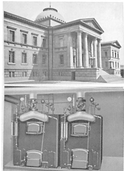
煉炭炊き大型及び中型セクショナルボイラ（プデルス社、ローラー工場） 伝熱面積48.25㎡、1920年からの増築工事における納品と考えられる
