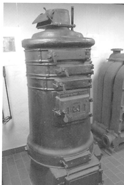
1910年製造、放熱量不詳。70年にわたり使用されたボイラ
