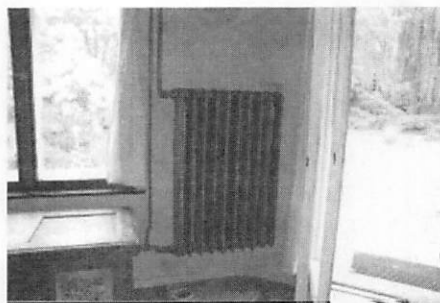
写真- 13 タウト設計旧自邸内部の赤と青に着色された放熱器
