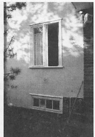
写真-7 ボイラの燃焼対策および縦方向の換気流入口としての地下室換気窓 (Waldsiedlung Onkel Toms Hütte)
