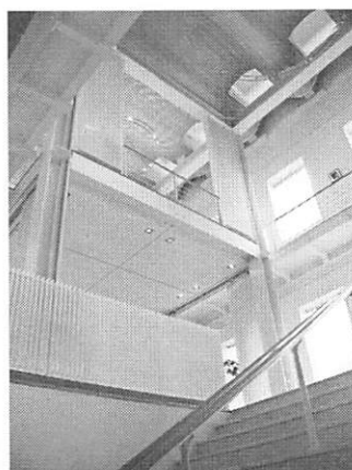
写49 熊本の事務所建築で使用された放射冷暖房用放熱器放熱器が手すり、間仕切りに利用される
