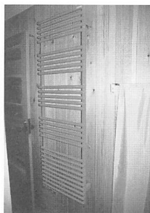
写43 タオルの乾燥にも使用できる脱衣室設置の放熱器 (岩手県のゲストハウス)
