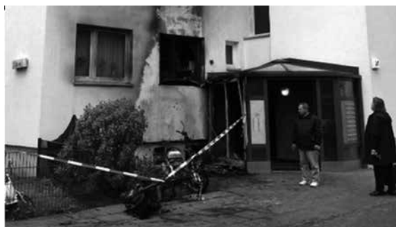
写真4 ハンブルグの高層住宅で外壁に近接して駐車されたバイクから火災発生
