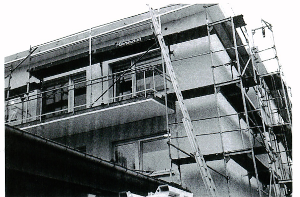
写真16 StuttgartのWallgrabenにある塗装会社のビルの外断熱改修(平成13年10月撮影)
