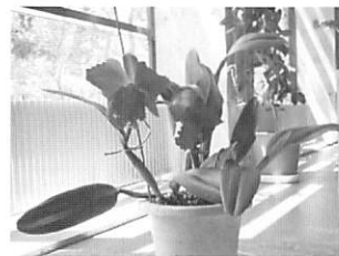
写真26 室内緑化と共存する放熱器
