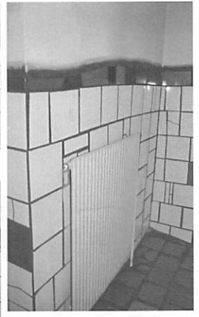
写真21 トイレに設置された温温水暖房放熱器(芸術の家)
