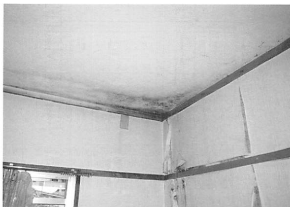
Photo 1 内断熱の建物で壁紙が破れた状態
