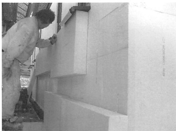
写真5 パッシブハウスではXPS120mmが2層にして外断熱が施工された。
