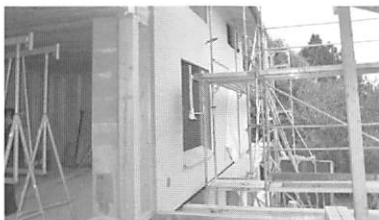
写真11 木造住宅の施工現場(木質繊維断熱板が使用されている)
