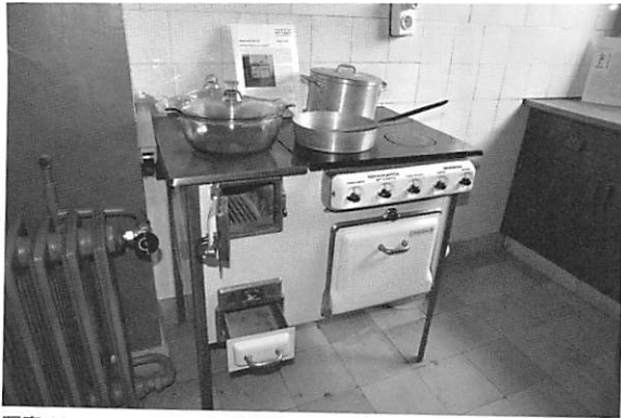
写真13 フランクフルト厨房の調理オープン
