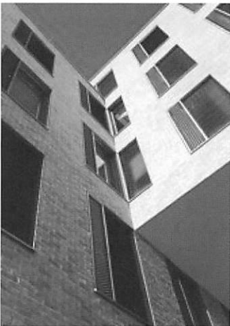
写真16 磁器仕上げの湿式外断熱
