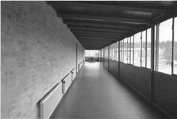
写真19 室内側に設置された放熱器
