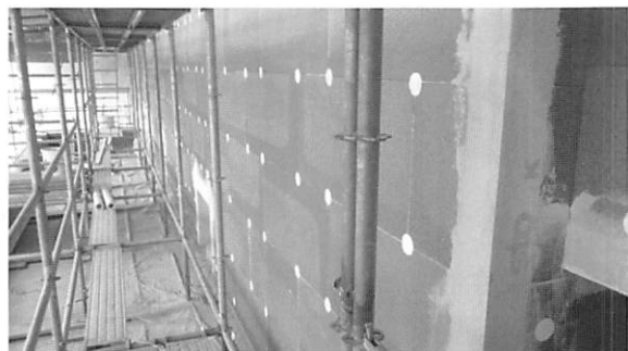
写真3 炭素粒子混入のEPSを使用した外断熱工事の例、断熱材厚さ10cm、YKK社黒部、施工戸田建設株式会社
