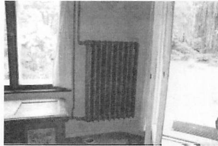
写真- 13 タウト設計旧自邸内部の赤と青に着色された放熱器
