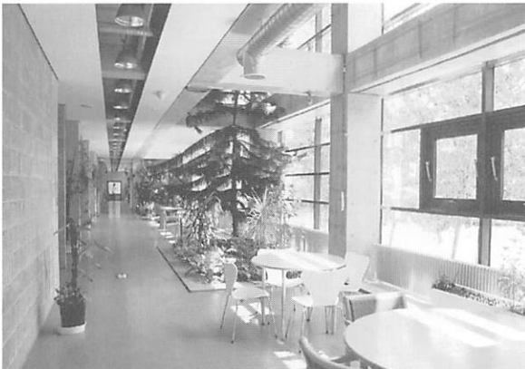
写真-18 室内緑化と共存する放熱器
