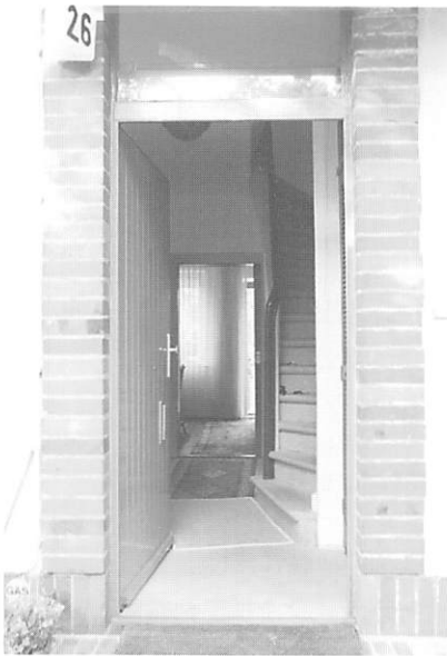
写真-4 煙突効果を利用した自然換気のための急な階段
