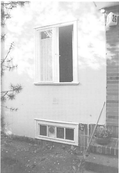
写真-5 Waldsiedlung Onkel Toms Hütteの Eisvogelweg に建つ住宅の換気口
