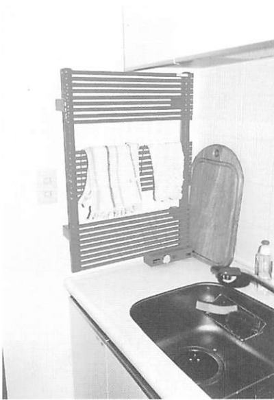
写真-17 厨房における放熱器
